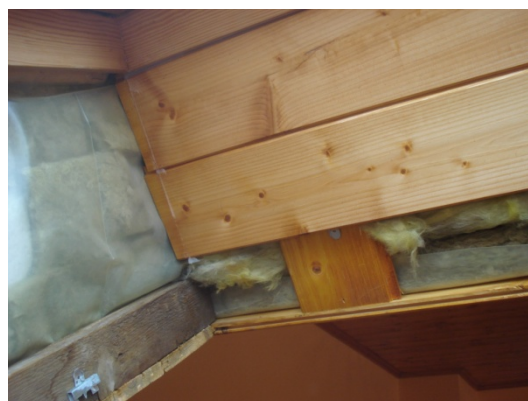
Netěsné napojení parotěsné vrstvy na střešní okno
