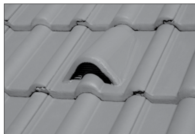
Detailní záběr na tašku větrací ve střeše
